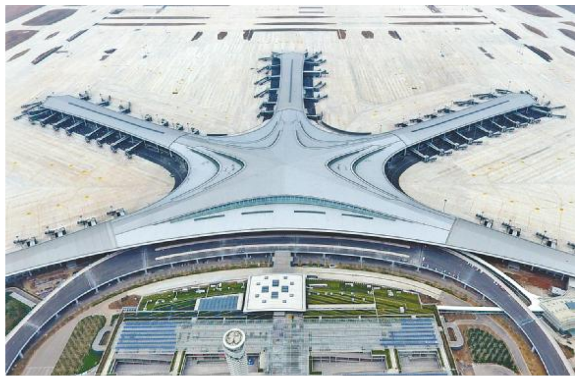
建设中的青岛胶东国际机场(3月25日摄,无人机照片)。近日,青岛胶东国际机场项目全面复工。截至目前,机场飞行区、货运区完成竣工验收,进出港主流程具备演练条件,整个工程已到了“收关冲刺”阶段。
